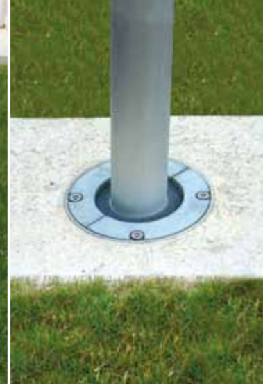
Betonfundament mit Bodenhalterung M.
