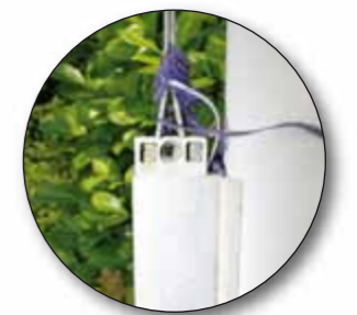
Hissvorrichtung außen, wartungsbedürftig.
